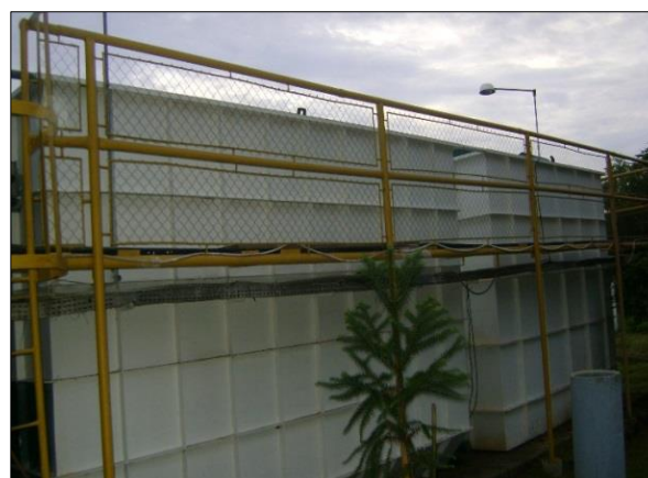
Figura 24 – Unidade de tratamento
