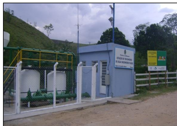
Figura 31 – Vista da ETA Engenheiro Passos
