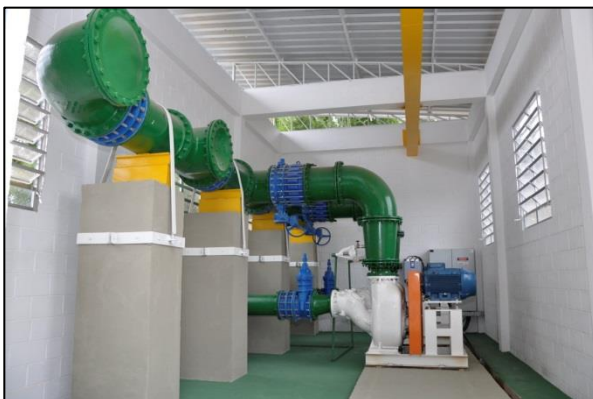
Figura 11 – Sistema de captação do novo módulo - ETA Alegria
