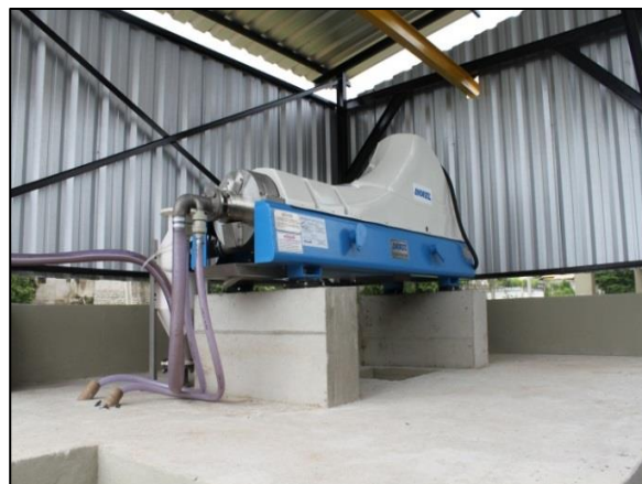
Figura 59 – Centrífuga de desidratação de lodo.
