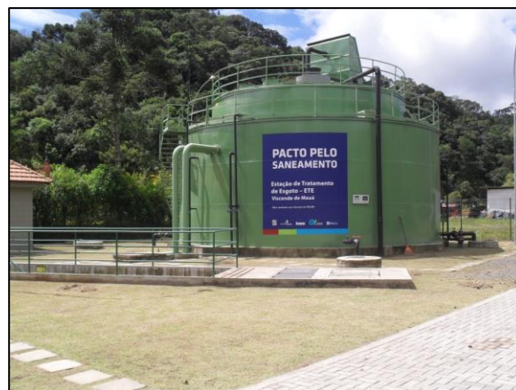
Figura 66 – Unidade de Tratamento
