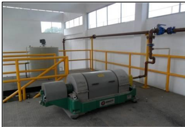
Figura 13 – Área de tratamento de lodo - ETA Alegria
